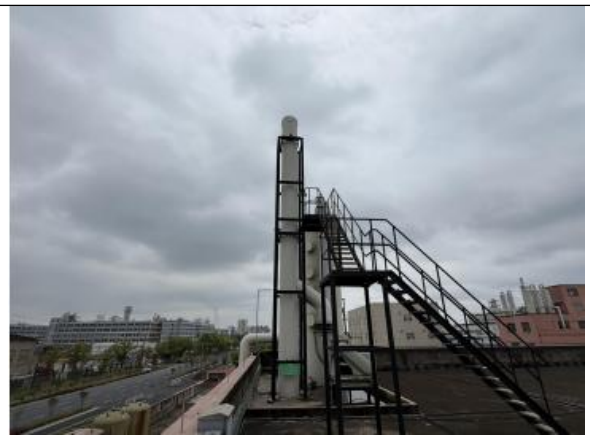
危废仓库废气排放口 (DA021)
