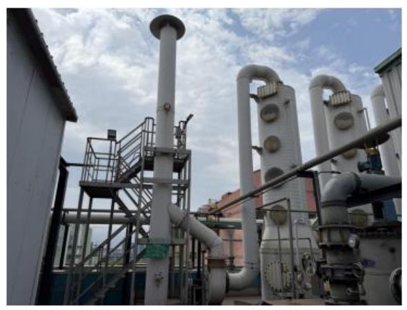
NAS 生产线废气排放口 (DA011)
