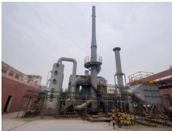
RTO 排放口 (DA010)
