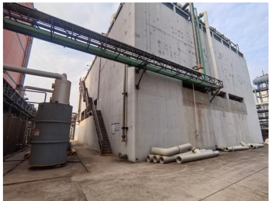
低浓度废水预处理设施
