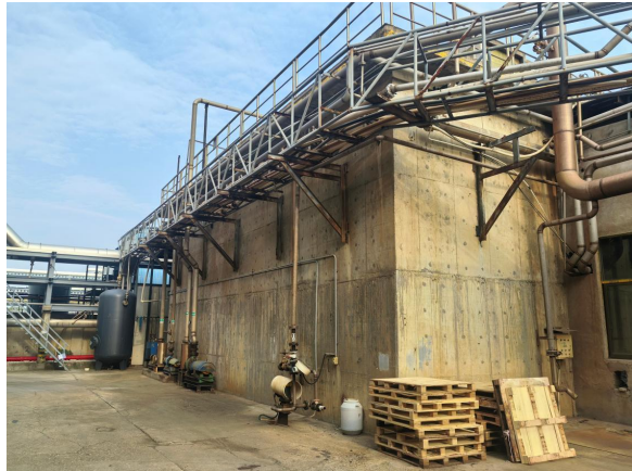
综合废水处理设施
