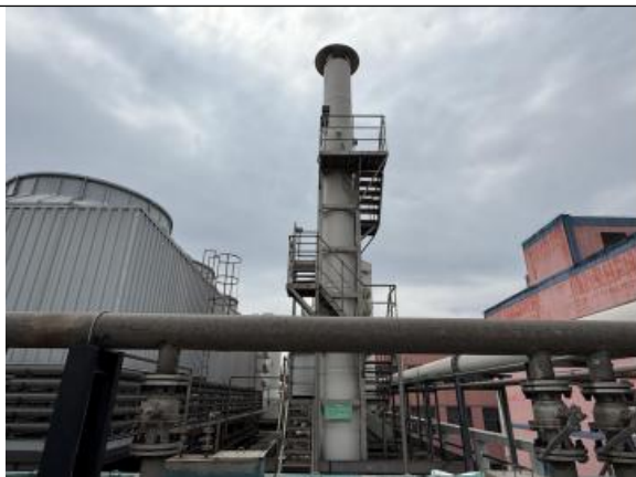
污水站低浓度废气排放口 (DA022)
