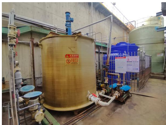
高浓度废水预处理设施
